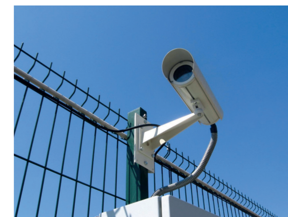
Решения для прокладки слаботочных кабельных трасс и систем безопасности
