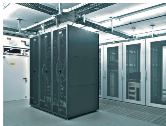
Серверные и уличные шкафы
